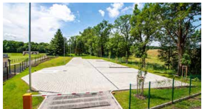
Zkolaudováno bylo nově postavené stání pro obytná vozidla. V příštím roce doplníme potřebnou infrastrukturu.
