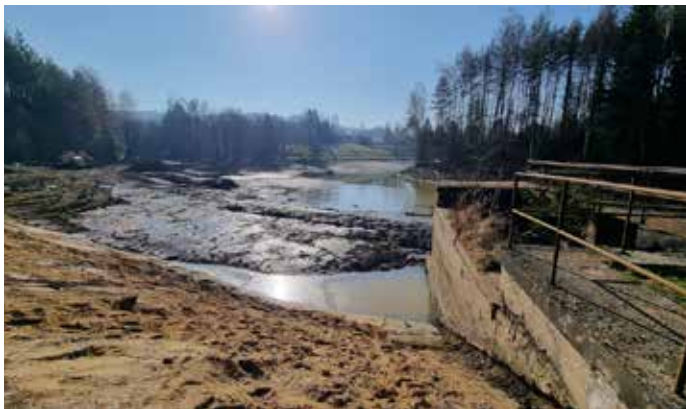
Součástí prací na rekonstrukci Kyjovské přehrady je i vybudování boční tůně pro obojživelníky a další vodní živočichy.
