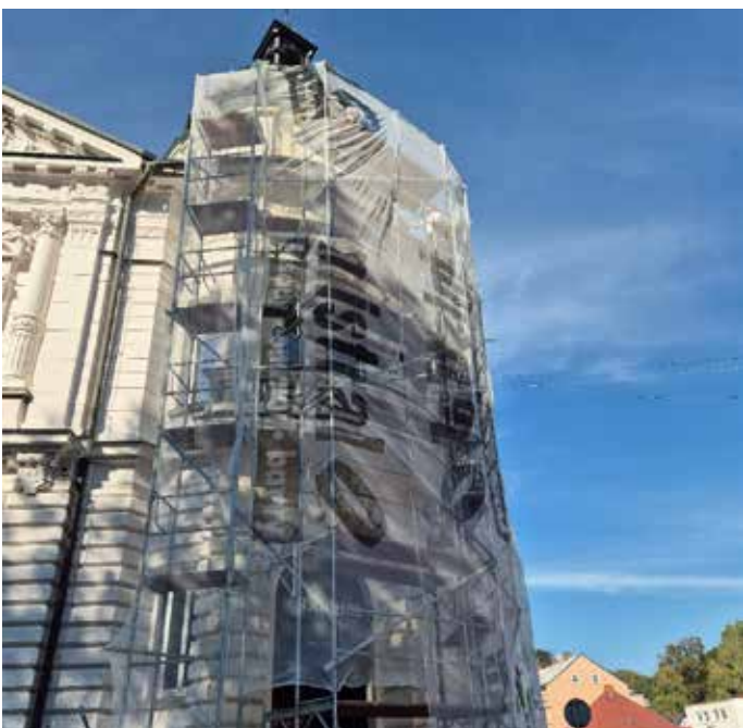
V letošním roce jsme realizovali druhou etapu obnovy fasády historické budovy radnice.
