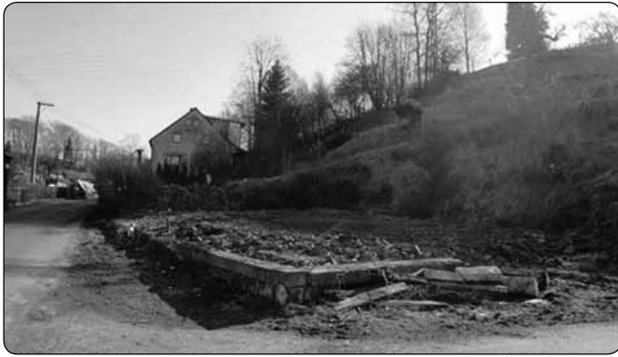
Po mnoha letech se podařilo, díky vstřícnosti nového vlastníka, dosáhnout odstranění nevzhledného zbořeníště na Varnsdorfské ulici.
